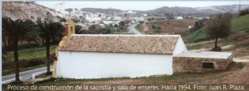
Proceso de construcción de la sacristía y sala de enseres. Hacia 1994. Foto: Juan R. Plaza.
